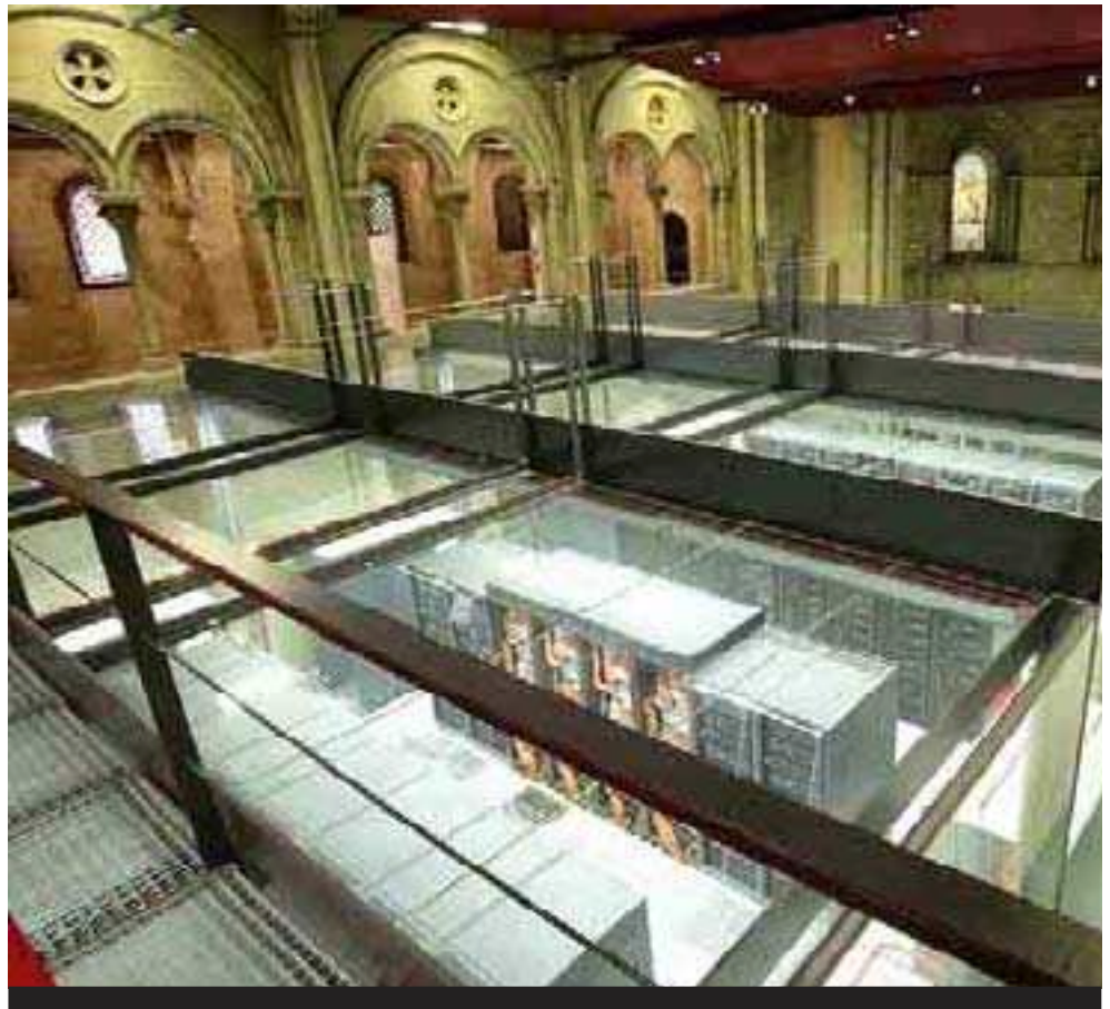
Interior del Barcelona Supercomputing Center, que aloja uno de los ordenadores más potentes del mundo en una antigua capilla de Torre Girona. / D. UMBERT
